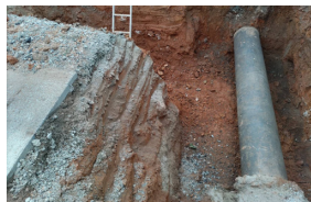
既設の水道管です? 直径は約500mmです!
